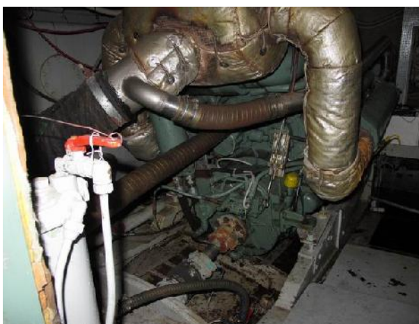
Foto 61 – Motore di sinistra con riduttore visto dal locale tecnico di poppa
