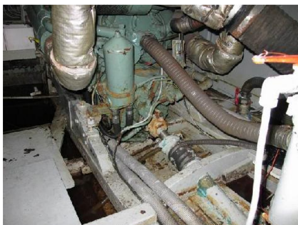
Foto 62 – Motore di dritta con riduttore visto dal locale tecnico di poppa
