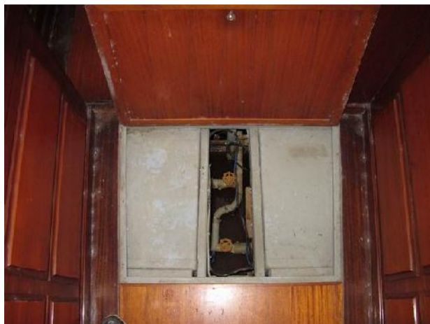
Foto 46 – Cabina armatore: botola casse acque grigie e acque nere
