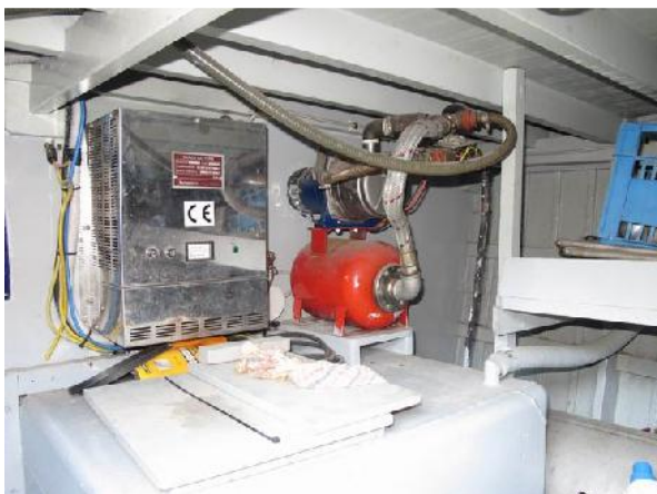
Foto 59 – Caricabatteria e autoclave montaliquidi
