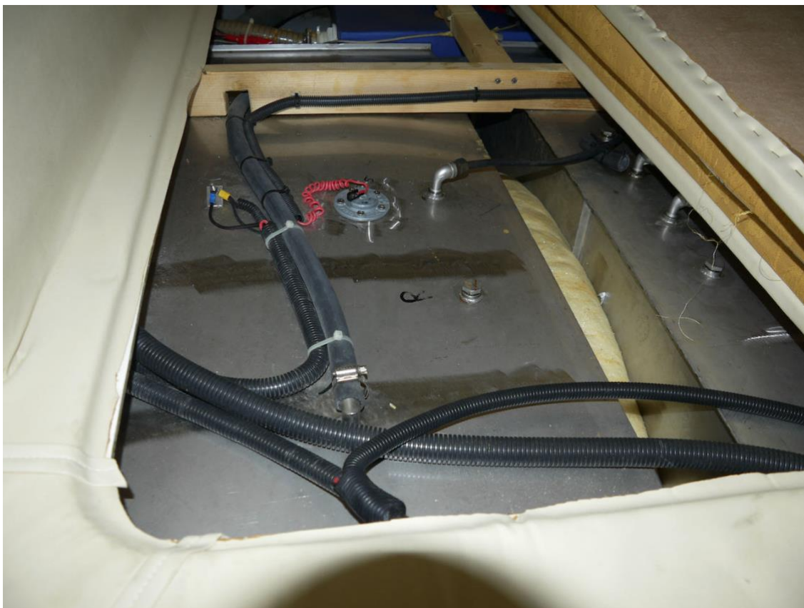
Serbatoio carburante e serbatoio acqua lavanda
