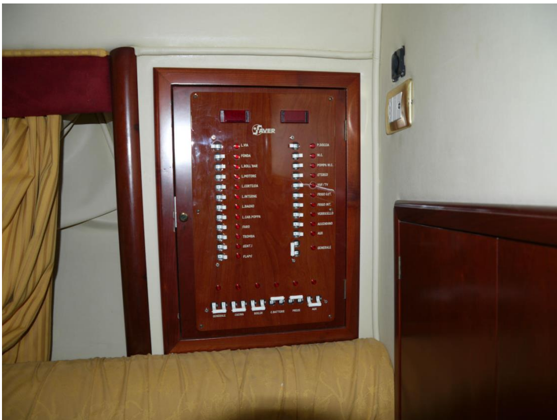
Quadro elettrico principale in zona alloggi
