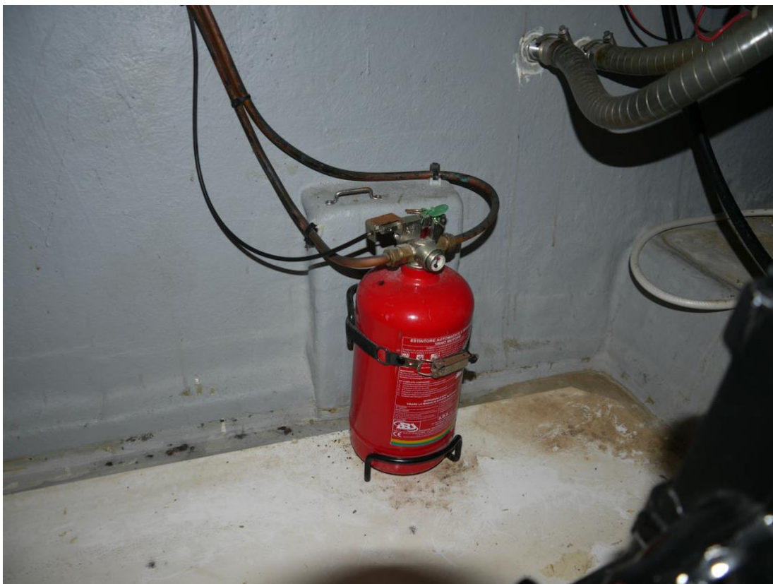
Impianto estinzione incendio in apparato motore
