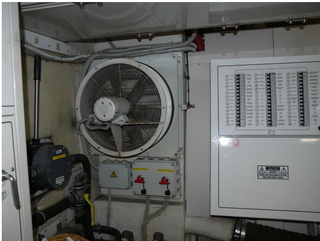
Quadro elettrico principale e ventilazione forzata in apparato motore
