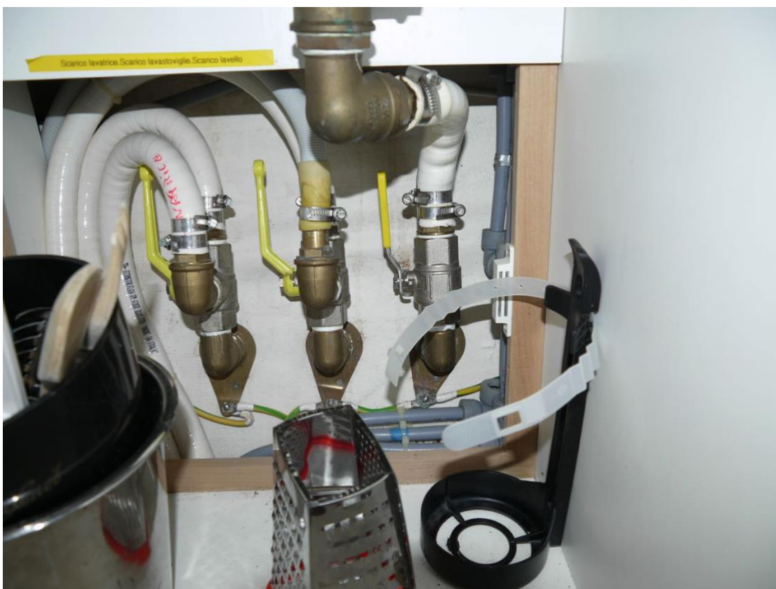
Scarichi a mare in zona cucina
