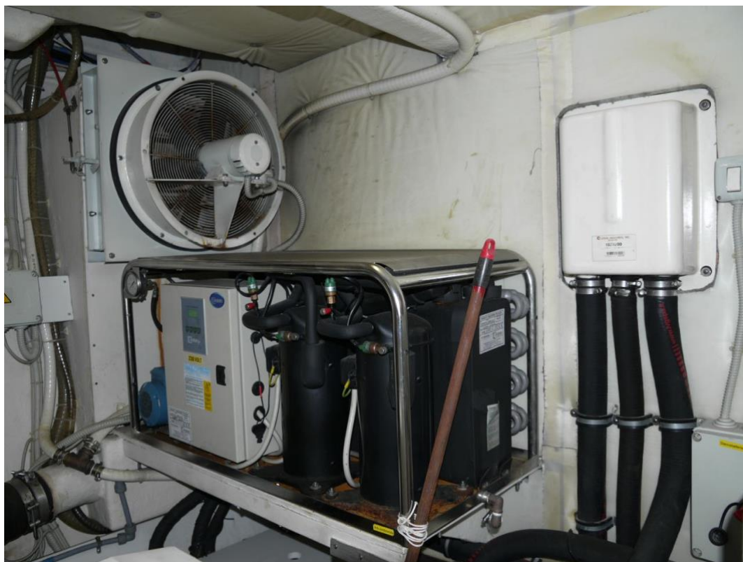
Impianto di condizionamento
