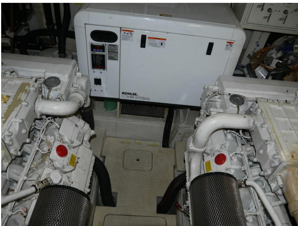
Locale apparato motore con gruppo elettrogeno Kohler
