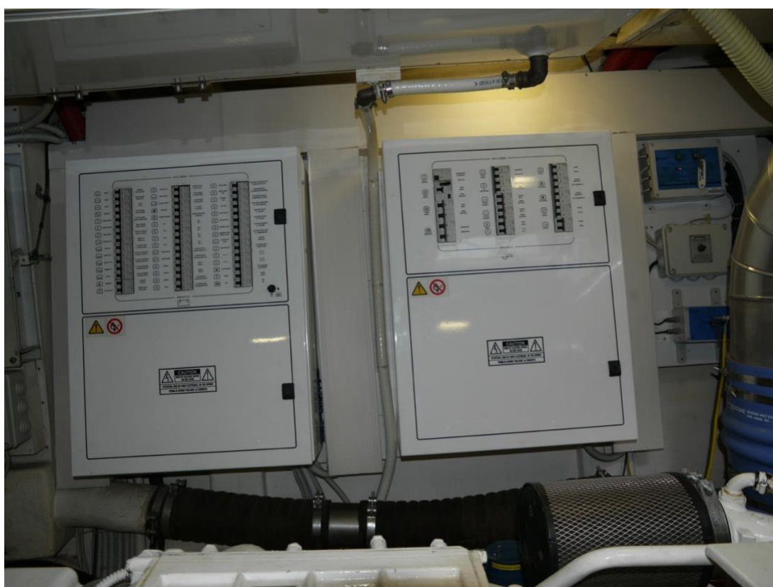
Quadro elettrico principale
