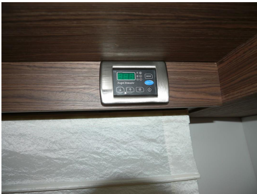
Dettaglio di allestimento cabina centrale – centralina condizionamento
