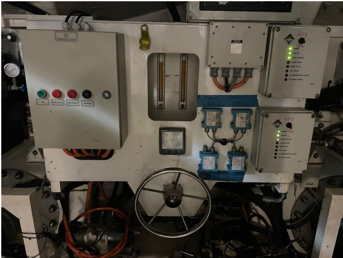
Apparecchiature in apparato motore : timoneria di emergenza
