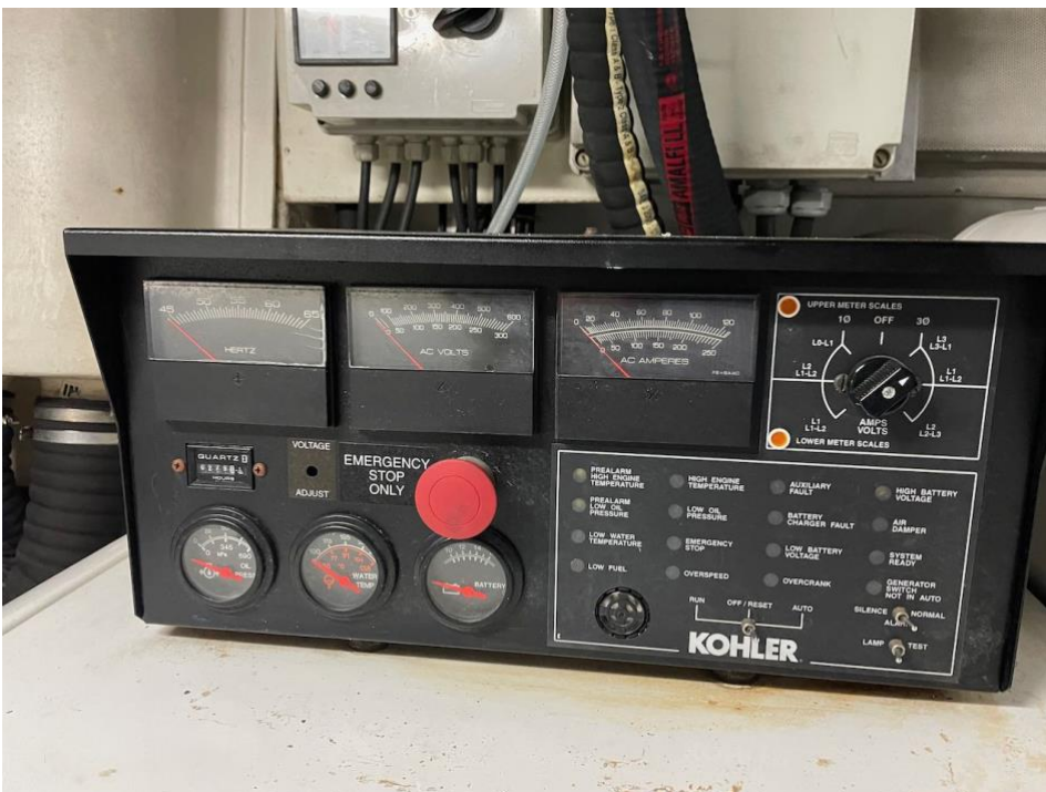
Apparecchiature in apparato motore : quadro controllo gruppo elettrogeno
