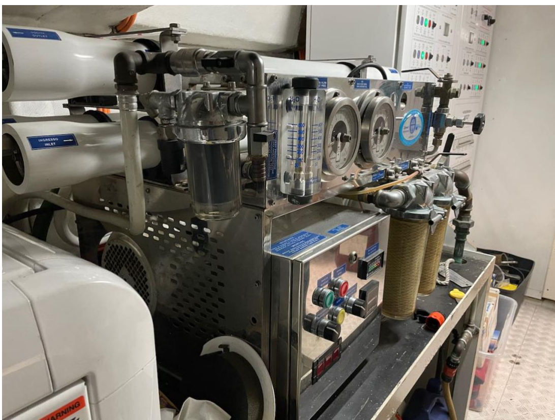
Apparecchiature in apparato motore : dissalatore
