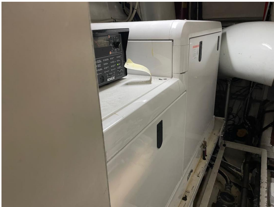
Apparecchiature in apparato motore : gruppo elettrogeno
