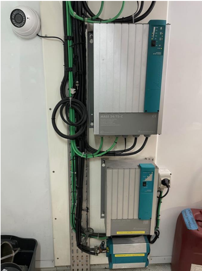
Apparecchiature in apparato motore : carica batterie
