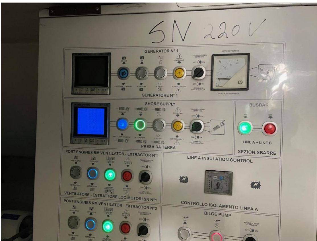
Quadro elettrico principale in sala macchine
