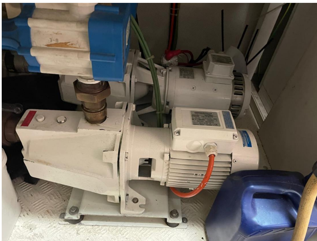
Apparecchiature in apparato motore : pompa acqua mare
