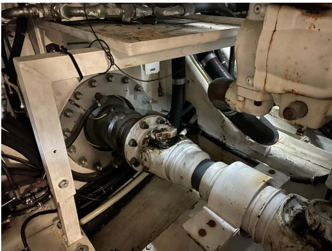
Apparecchiature in apparato motore : linea d'asse di sinistra
