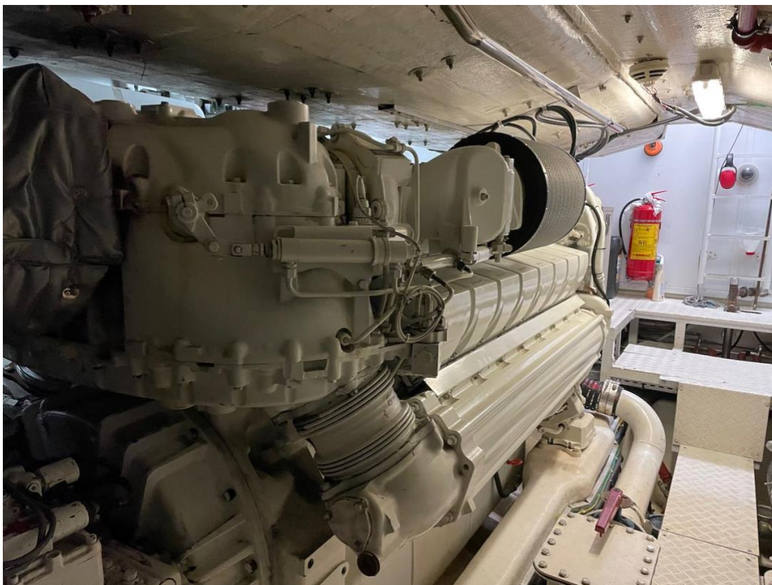
Locale apparato motore : motore di sinistra
