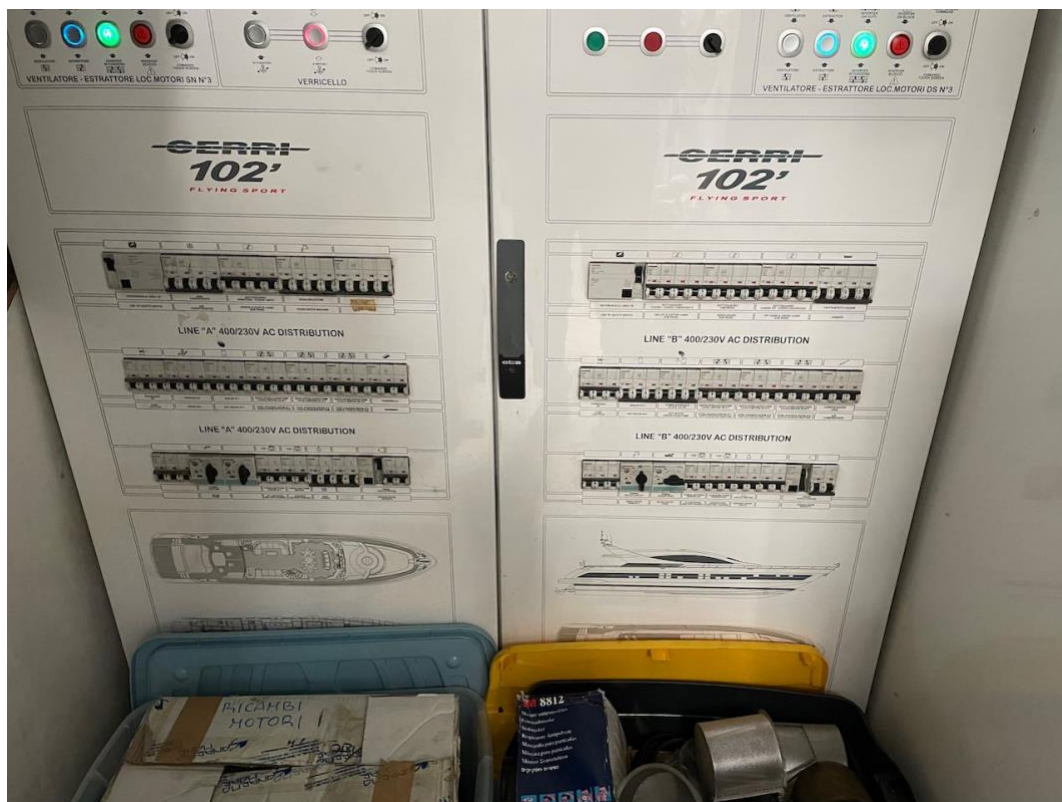
Quadro elettrico principale in sala macchine
