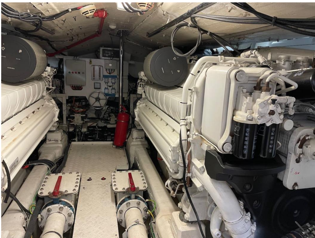
Locale apparato motore - motore di sinistra
