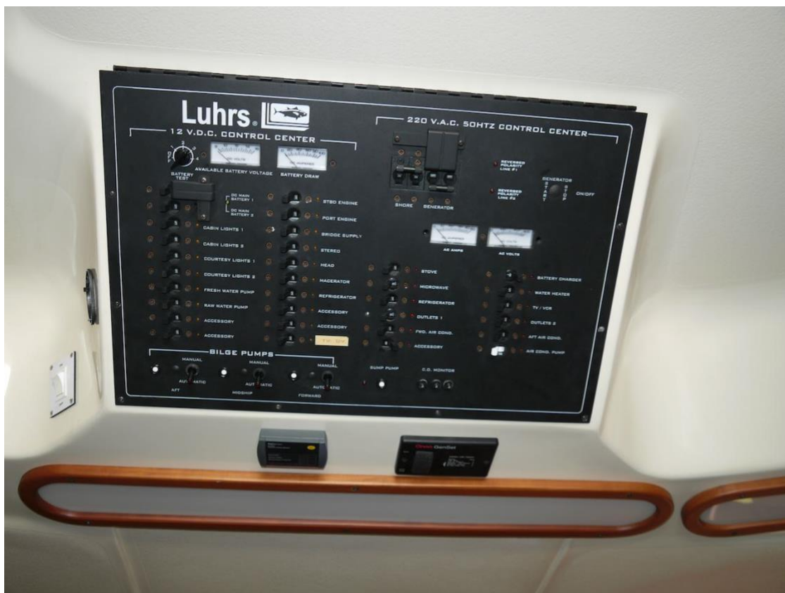
Quadro elettrico principale
