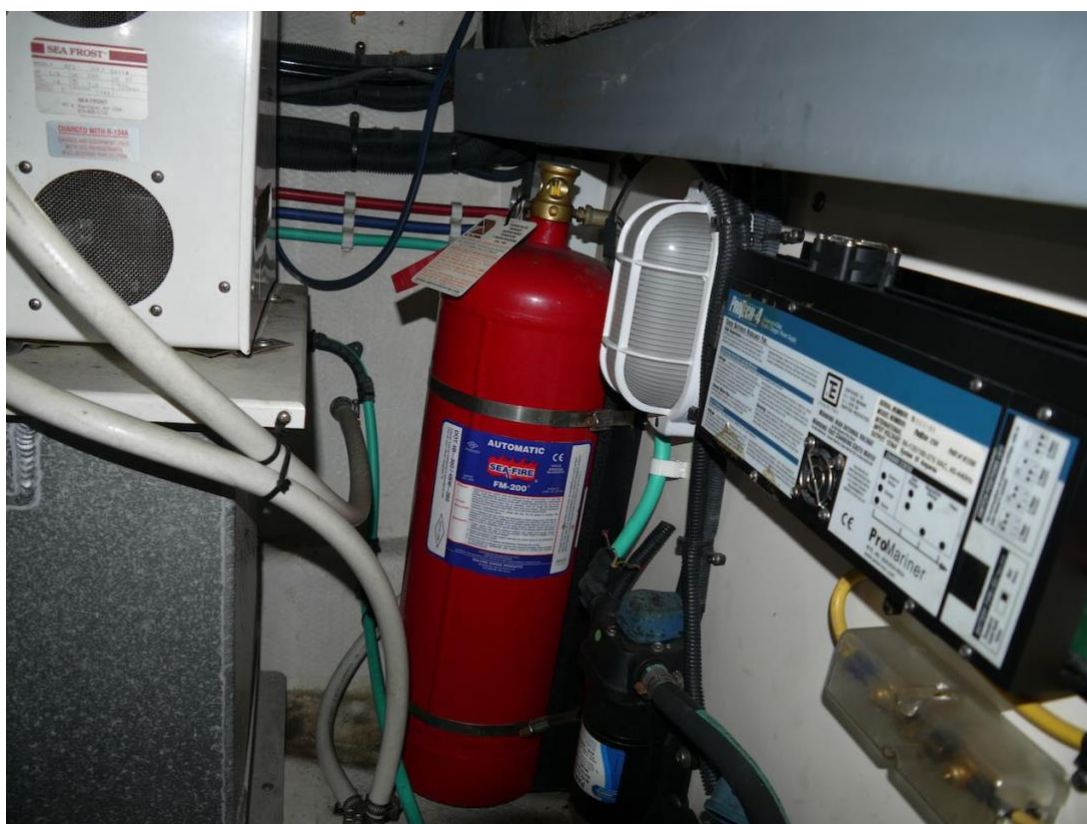
bombola antiincendio in apparato motore
