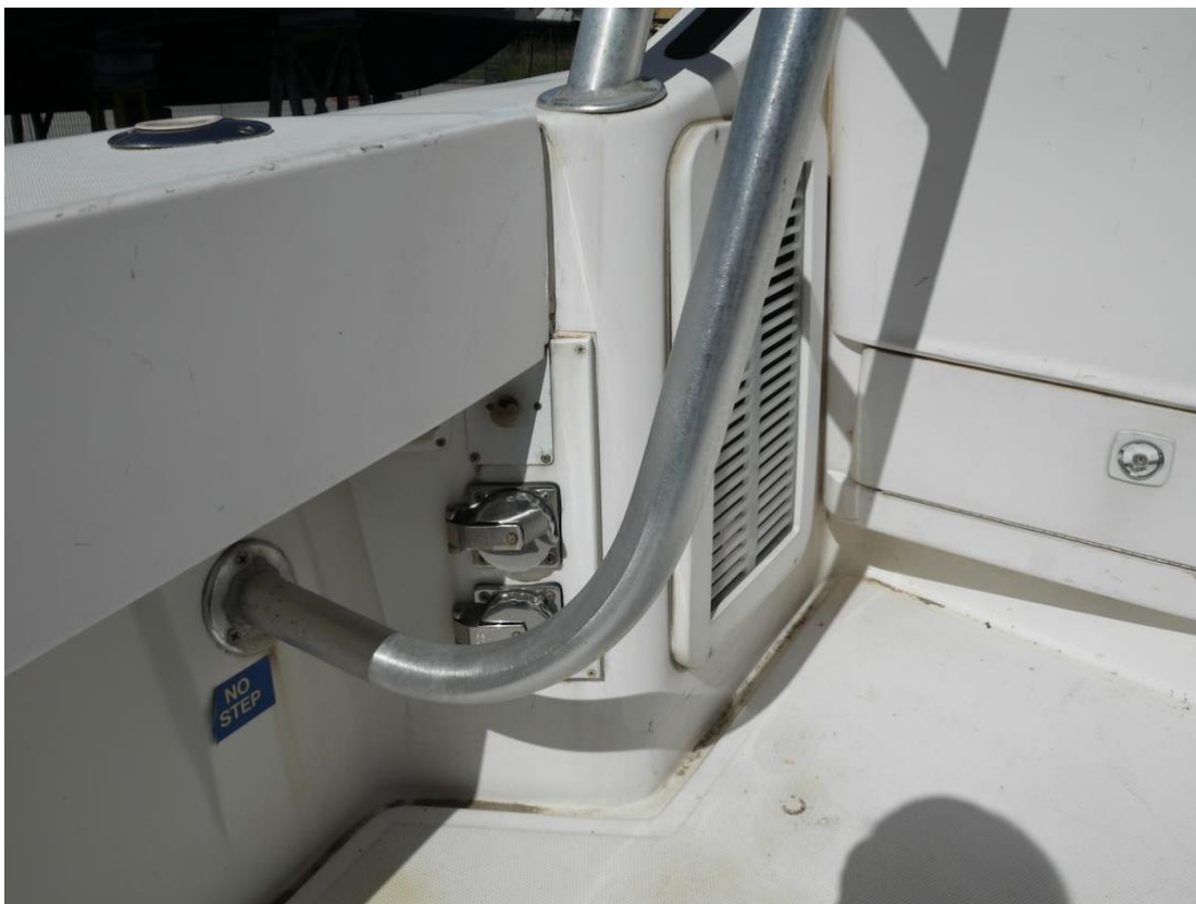
Servizi in coperta : prese da terra
