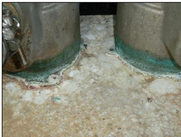
Photo 16 : corrosion des filtres d'eau de mer
