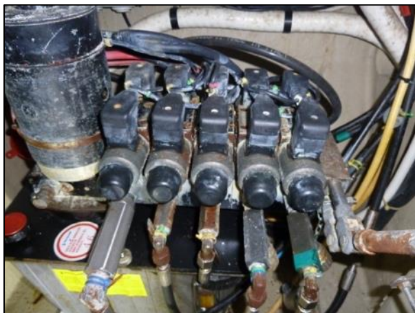
Photo11 : groupe hydraulique passerelle
