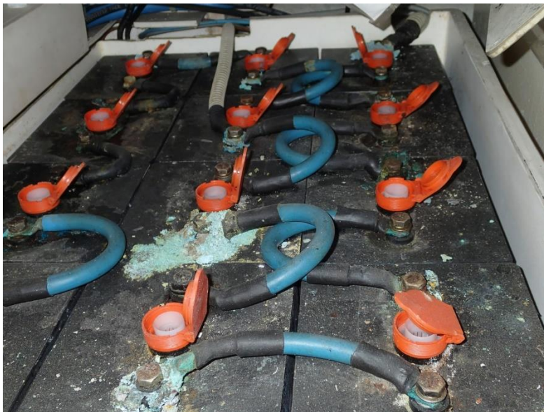
Photo 12 : parc batteries éléments de 2 V HS
