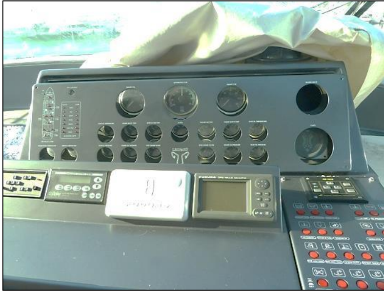
Photo 9 : tableau de commande
