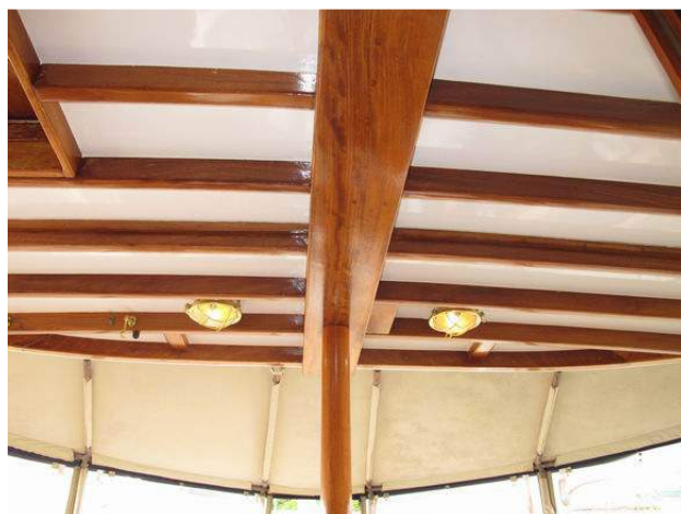
Foto 6.6 – Pozzetto: cielino con bagli e punti luce
