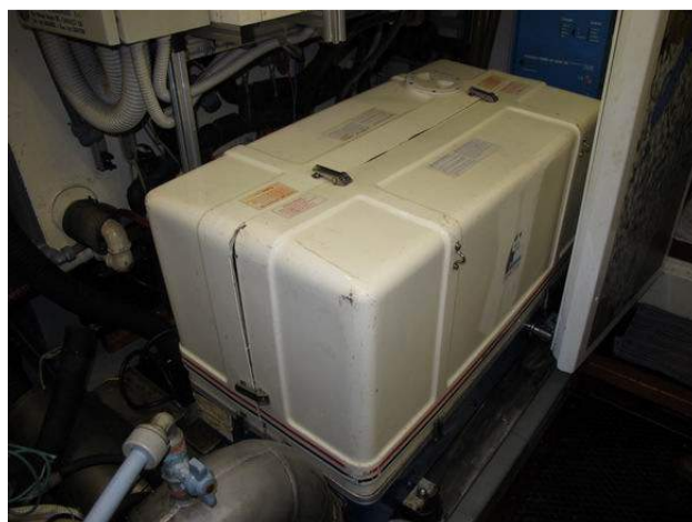
Foto 10.14 – Sala macchine: Diesel generatore (a destra della porta di accesso alla sala macchine)
