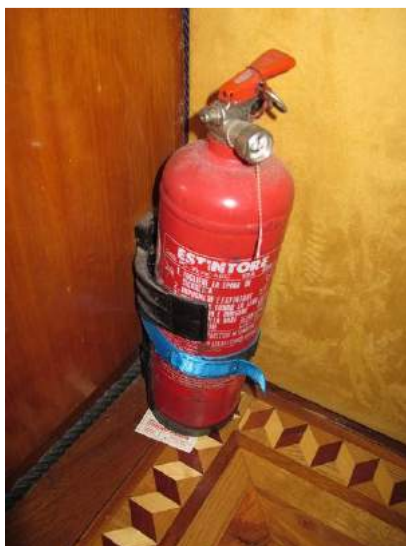
Foto 9.27 – Cabine ospiti: estintore cabina di dritta
