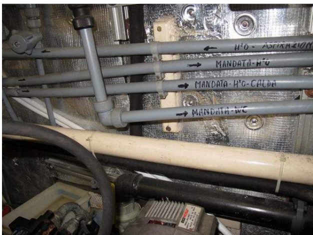
Foto 10.19 – Tubazioni impianto acqua calda e fredda
