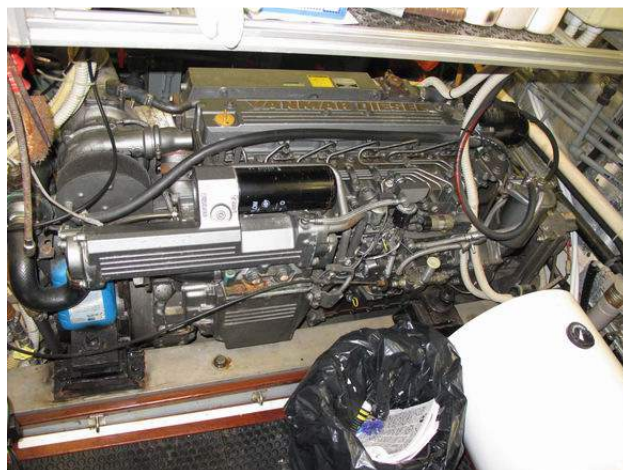
Foto 10.6 – Sala macchine: motore di sinistra
