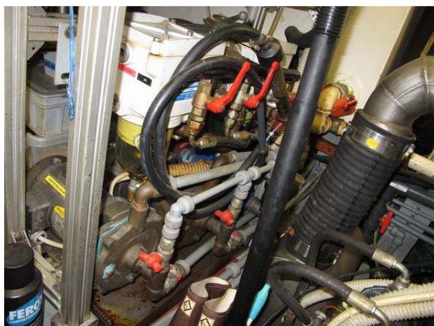
Foto 10.13 – Pompa di servizio dissalatori
