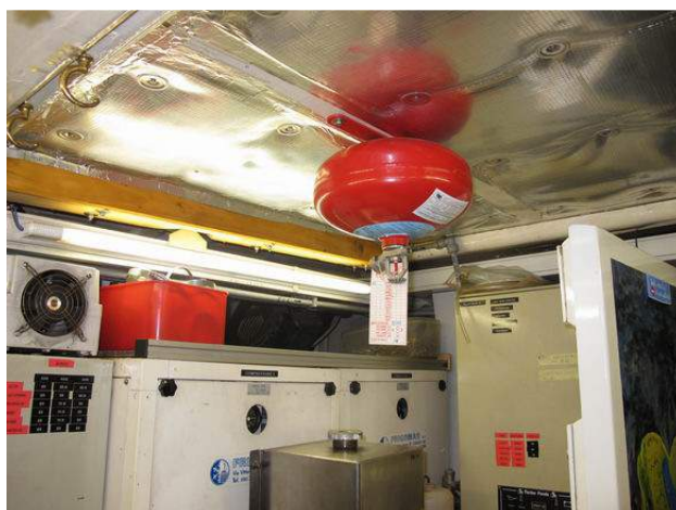
Foto 10.22 – Estintore a pioggia
