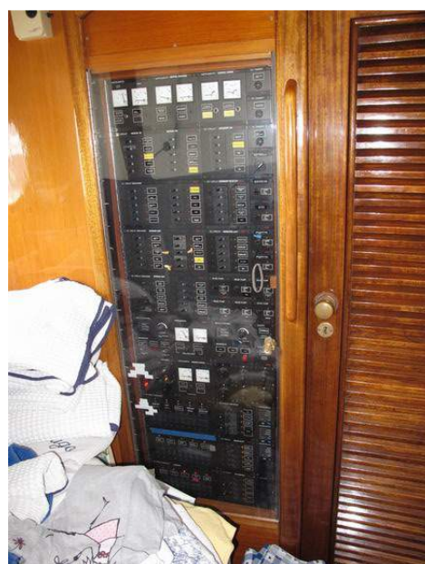
Foto 8.10 – Plancia: quadro elettrico
