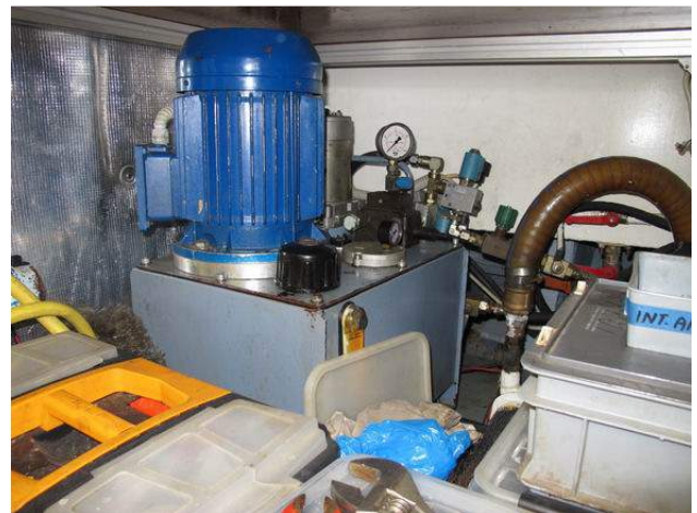
Foto 10.4 - Centralina idraulica pinne stabilizzatrici
