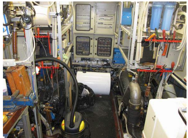
Foto 10.2 – Sala macchine: vista dalla porta verso l'interno con quadro elettrico e boiler acqua calda
