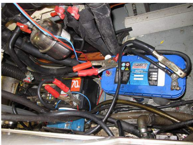
Foto 11.17 – Sala macchine: batterie servizi
