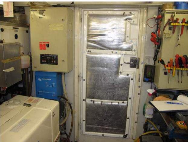
Foto 10.1 – Sala macchine: porta di accesso tagliafuoco vista dall'interno
