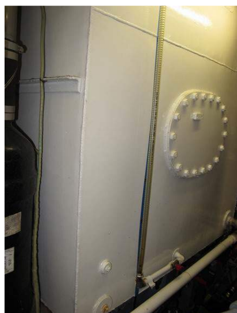
Foto 10.8 – Cassa combustibile di sinistra
