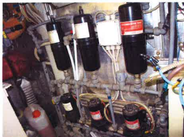
Foto 10.18 – Sala macchine: pompe e filtri impianto acqua calda e fredda
