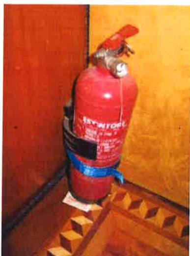
Foto 9.27 – Cabine ospiti: estintore cabina di dritta
