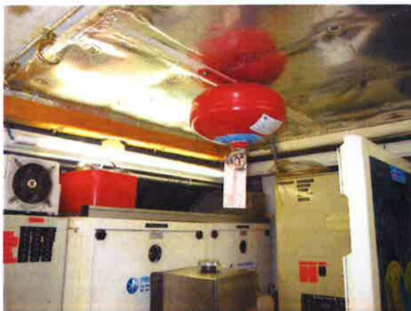
Foto 10.22 – Estintore a pioggia
