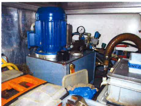
Foto 10.4 - Centralina idraulica pinne stabilizzatrici
