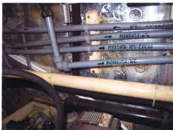
Foto 10.19 – Tubazioni impianto acqua calda e fredda
