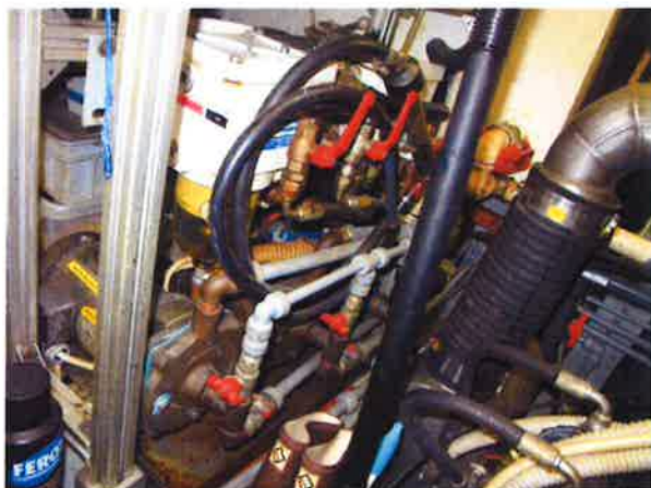
Foto 10.13 – Pompa di servizio dissalatori
