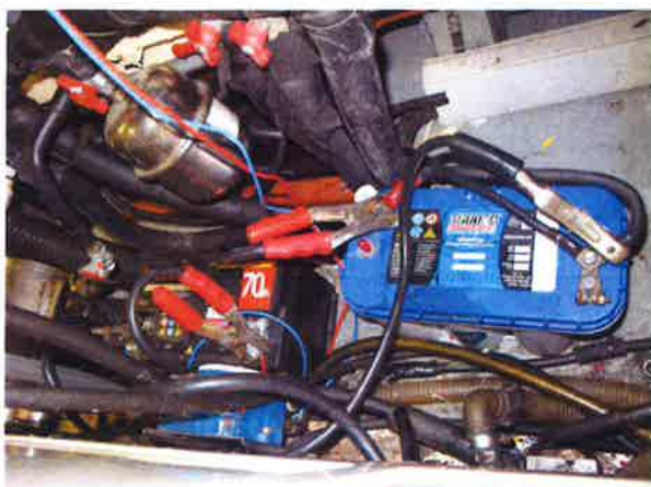
Foto 11.17 – Sala macchine: batterie servizi
