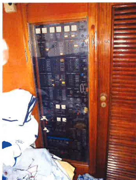
Foto 8.10 – Plancia: quadro elettrico
